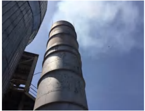
图 4-12 水泥窑窑尾排气筒
