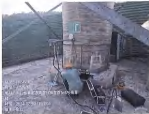
生活垃圾预处理工厂废气处理设施排气筒 (O2)
