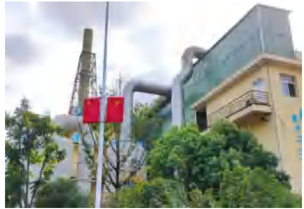
图 4-3 预处理厂生产车间设置微负压装置
