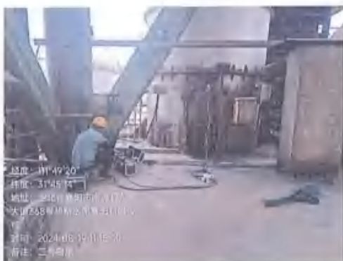
二号窑尾排气筒 (O1)
