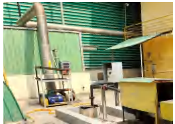
图 4-5 渗滤液收集池废气收集设施
