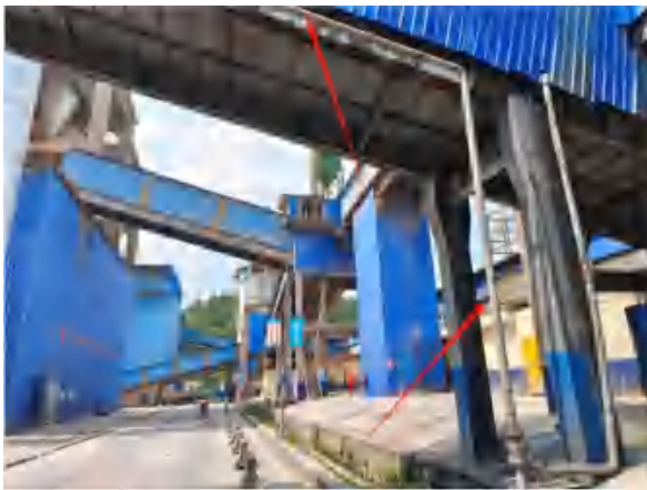
图 4-17 渗滤液入窑输送管道
