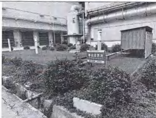
华新南漳再生资源利用有限公司现有 2#事故应急池（500m 3 ）
