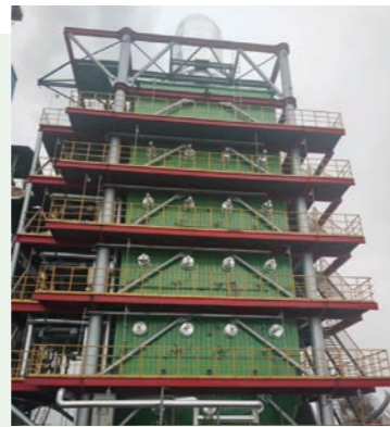
大冶公司高效 SCR 脱硝系统
